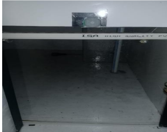
Gambar 4.40 Sensor PIR di Pintu bagian luar
