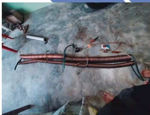
Gambar 3.7 Pipa Tembaga Kolektor
