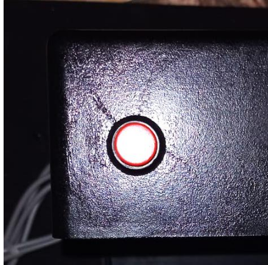
Gambar 4.12 Push Button pada Box Panel .
