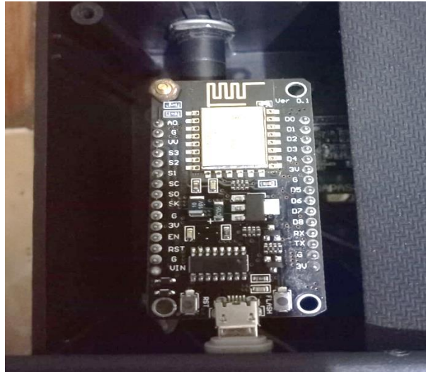
Gambar 4.8 NodeMCU ESP8266 pada Box Panel.
