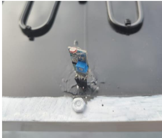
Gambar 4. 11 Pemasangan sensor LDR
