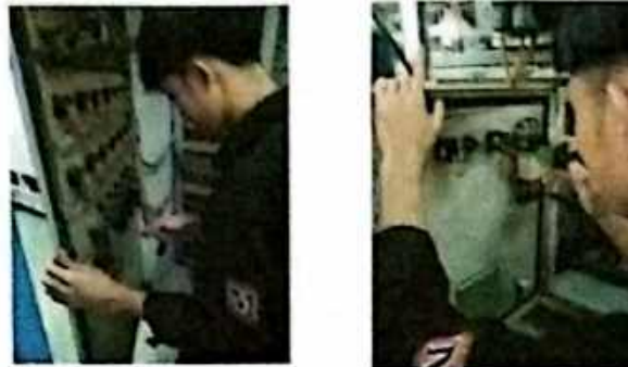
Gambar 2. 4 Penggantian Slector Switch ON/OFF pada Panel
