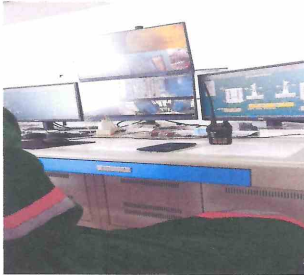
Gambar 2.14 Pengontrolan sistem boiler di komputer.
