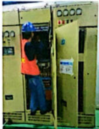
Gambar 2. 4 Site Mengganti CPU PLC Siemens S7-1200
