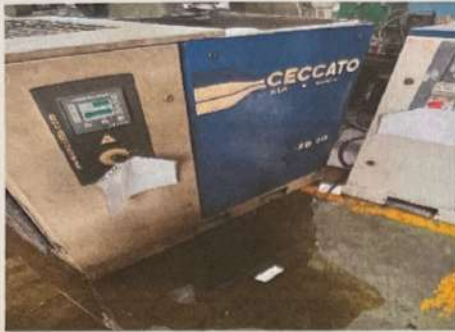
Gambar 2.5 Unit Mesin Kompresor
