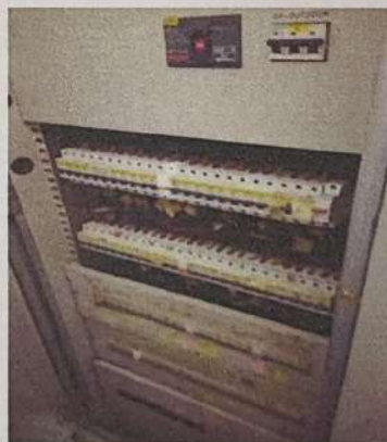
Gambar 7. Komponen elektrik dalam panel
