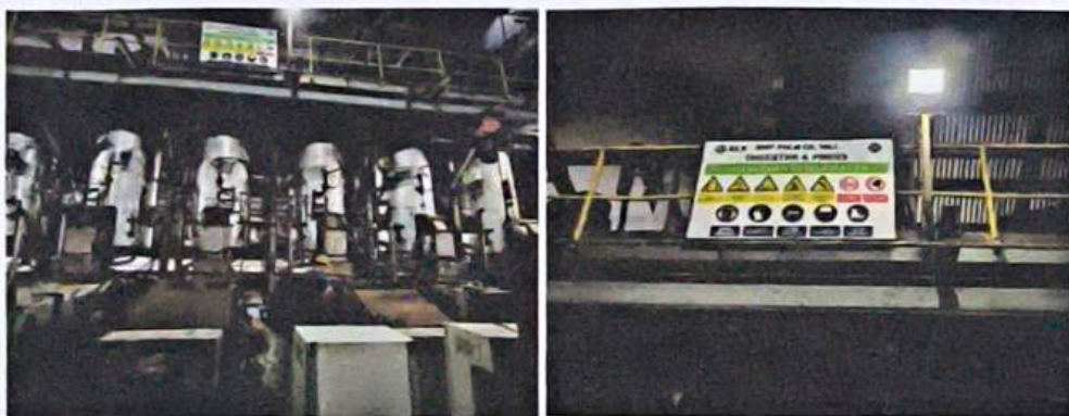
Gambar 2. 38 Digester dan Press Station
