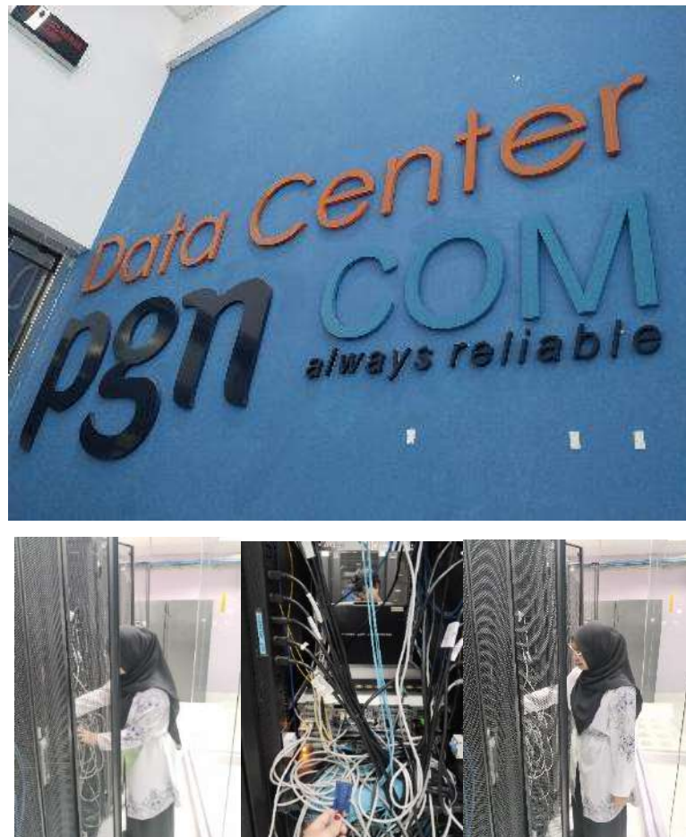
Gambar 2.2.5.14 Troubleshooting Aplikasi PGASOL di Data Center
