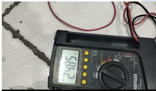
Gambar 4. 55 Pengukuran Tegangan Awal Baterai
