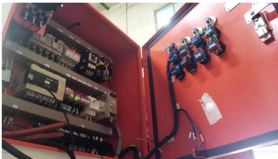
Gambar 2. 2 Panel yang Sedang Dilakukan Pengecekan
