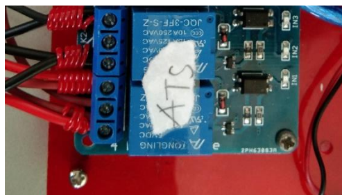
Gambar 4.50. Relay Digunakan sebagai ATS
