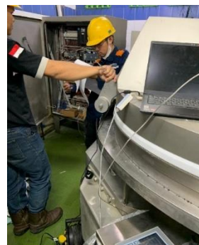
Gambar 2. 20 Pemasangan HMI dan Sensor Suhu PT MACHROPRIMA PANGANUTAMA
