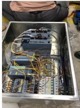
Gambar 2. 9 Terminasi Kabel Power MCB 220V dan DC24V PT.Machroprima Panganutama
