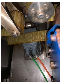
Gambar 2. 11 Terminasi kabel Provinet dan encoder pada motor PT.Machroprima Panganutama
