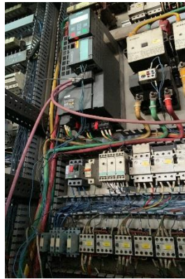
Gambar 2. 17 After VSD setelah diganti PT.KPI
