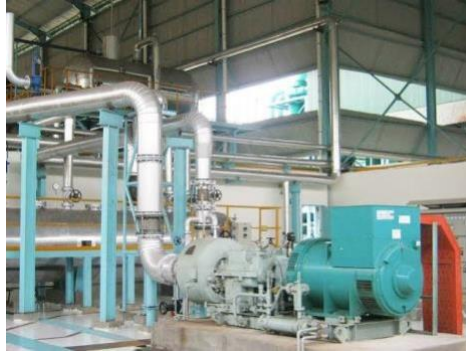
Gambar 17. Kamar Mesin (Turbin)
