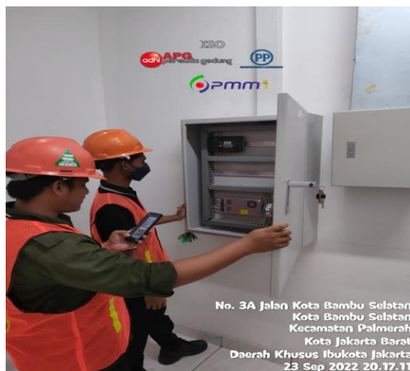
Gambar 2.6 Foto Pengecekan Panel BAS
