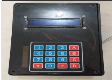
Gambar 4.12 Bentuk dari box kontrol keluaran generator
