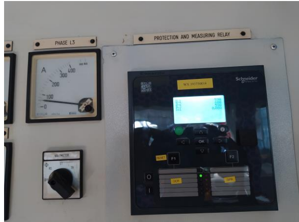
Gambar 2.3 Panel Indikator Monitoring Arus Penyulang di Wilayah Bangka
