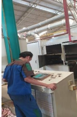
Gambar 16. Menghidupkan Burner dan Blower di Panel
