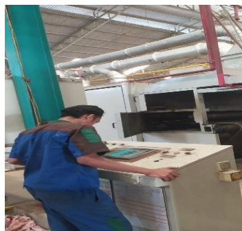
Gambar 2. 13 Menghidupkan burner dan blower di panel
