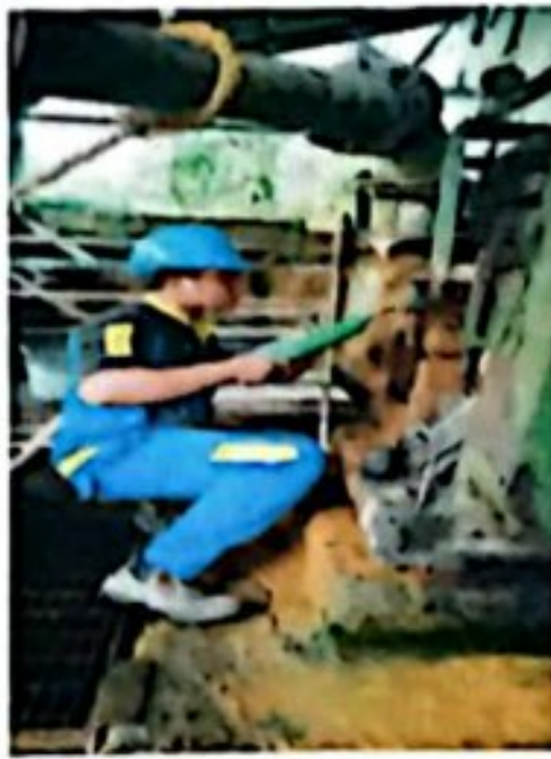
Gambar 2. 4 Pemberian grease pada rudal
