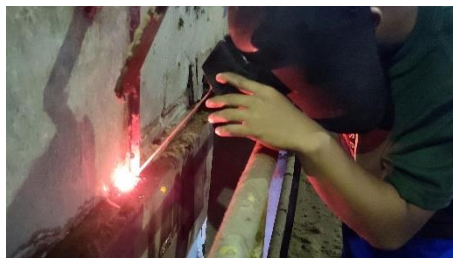
Gambar 2.7 Pengelasan Dinding Conveyor Yang bocor
