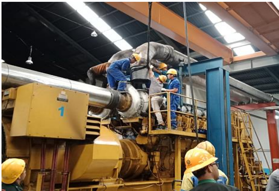
Gambar 2. 2 Pemeliharaan Caterpillar Engine Generator
