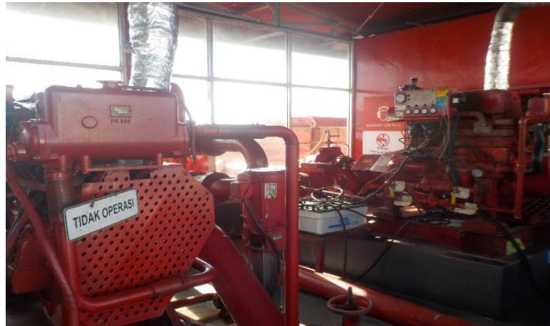
Gambar 1. 7 Mesin Pompa PMK
