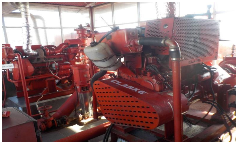
Gambar 1. 7 Mesin Pompa PMK
