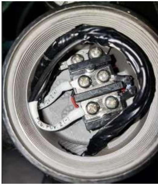
Gambar 2.37 Wiring pada control valve mixing tank 1 dan 2
