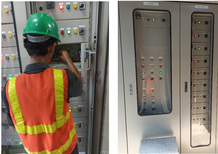
Gambar 2.35 Wiring panel PT. Sumber Indahperkasa
