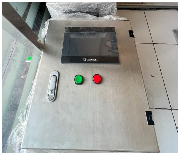
Gambar 1.3 Panel PLC dengan HMI application
