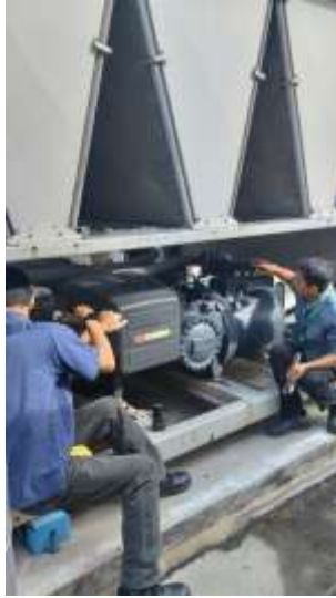
Gambar 2.19 Pengecekan mesin chiller
