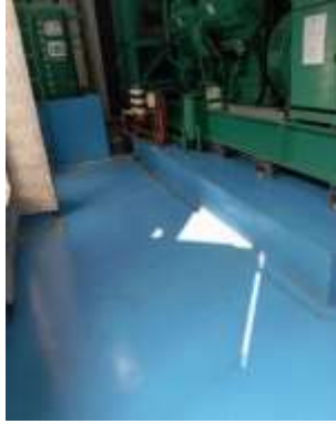
Gambar 2.15 Pengecekan sisi depan genset
