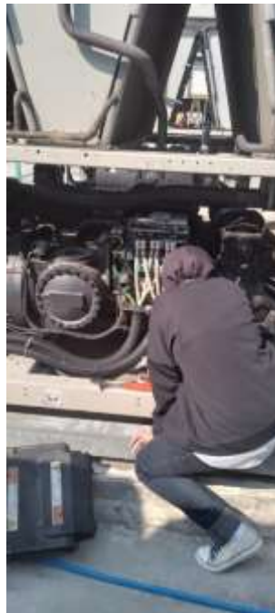
Gambar 2.18 Pengecekan mesin kompresor chiller
