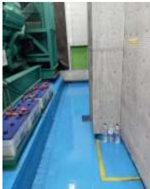
Gambar 2.16 Pengecekan bagian aki genset
