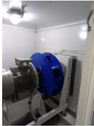
Gambar 2.30 Pengecekan bagian motor AHU
