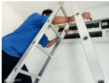
Gambar 2.26 pengerjaan AC rembes
