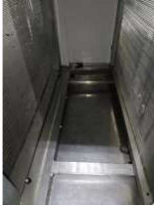
Gambar 2.32 Pengecekan bagian evaporator AHU
