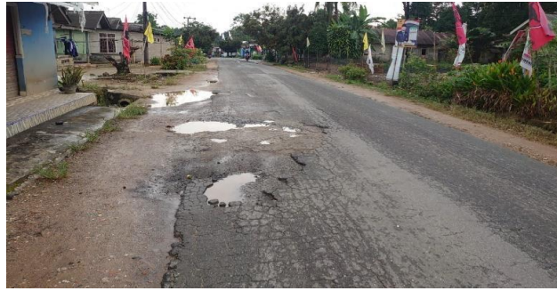
Gambar 1.1 Kerusakan jalan pada ruas jalan Sungai Selan - Kampung Gadong
