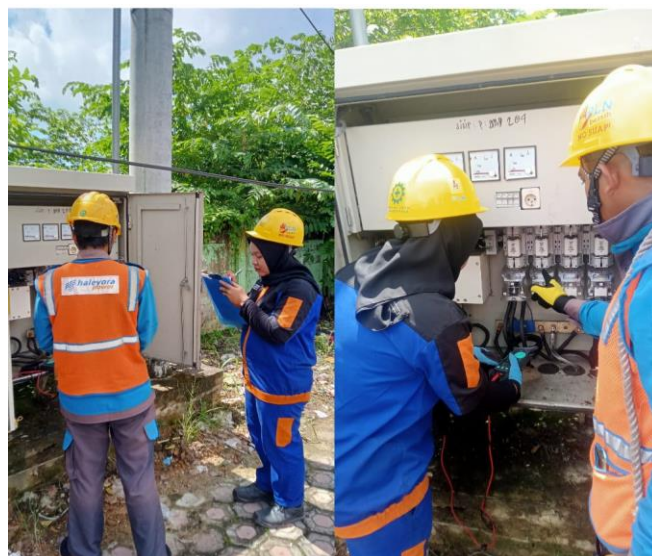
Gambar 2.16 Pengukuran arus tegangan dan pendataan gardu distribusi
