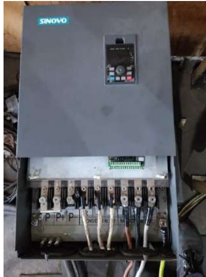
Gambar 2.6 Proses pengecekan trial menggunakan alat inverter (sinovo)
