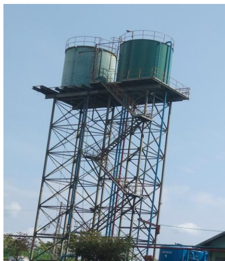
Gambar 2.24 Stasiun Water Treatment (WTP)
