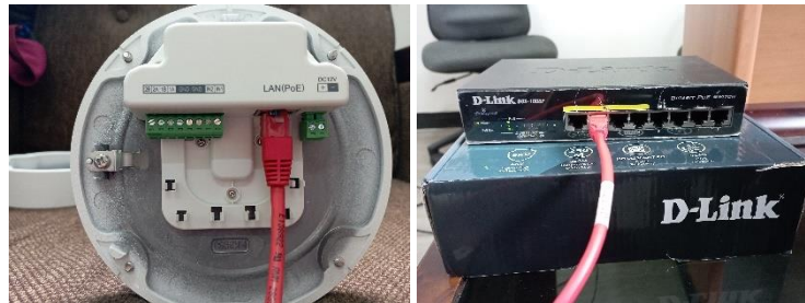
Gambar 2.7. Port POE Kamera CCTV ke POE Switch
