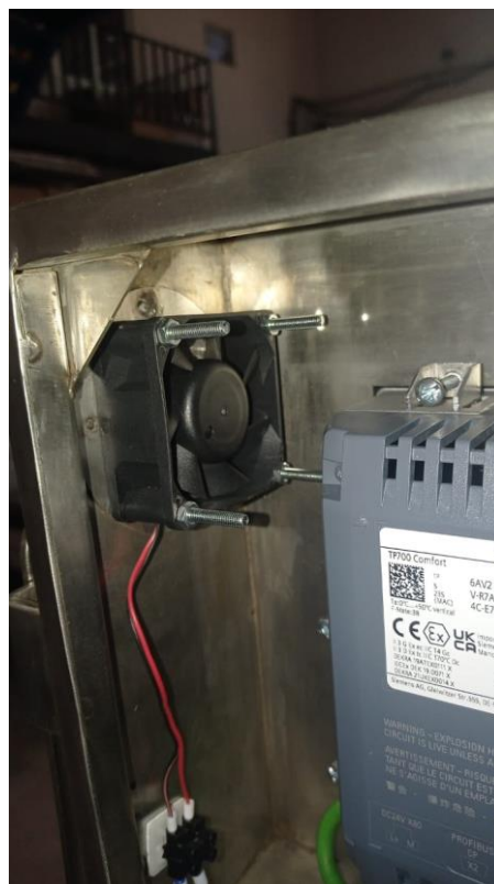
Gambar 2. 25 Pemasangan Exhaust Fan 24 VDC pada HMI Panel PT. Natural Indococonut
