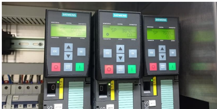
Gambar 2. 19 VSD motor yang telah diganti ke VSD baru di PT. Fonko International Pharmaceuticals
