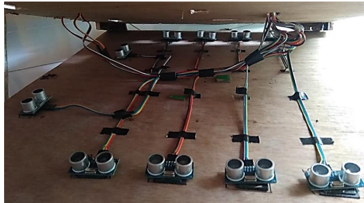
Gambar 4. 6 Hasil akhir wiring pada komponen
