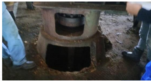
Gambar 2. 5 Coupling Digester (Sumber : PT. Gunung Maras Lestari-POM, 2023)
