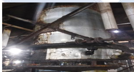
Gambar 1.2 Mesin Digester (Sumber : PT. Gunung Maras Lestari-POM, 2023)
