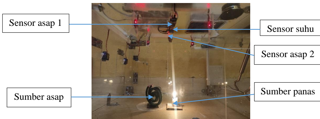
Gambar 4. 70 Pengujian Terdeteksi Asap dan Suhu pada Ruang 1
