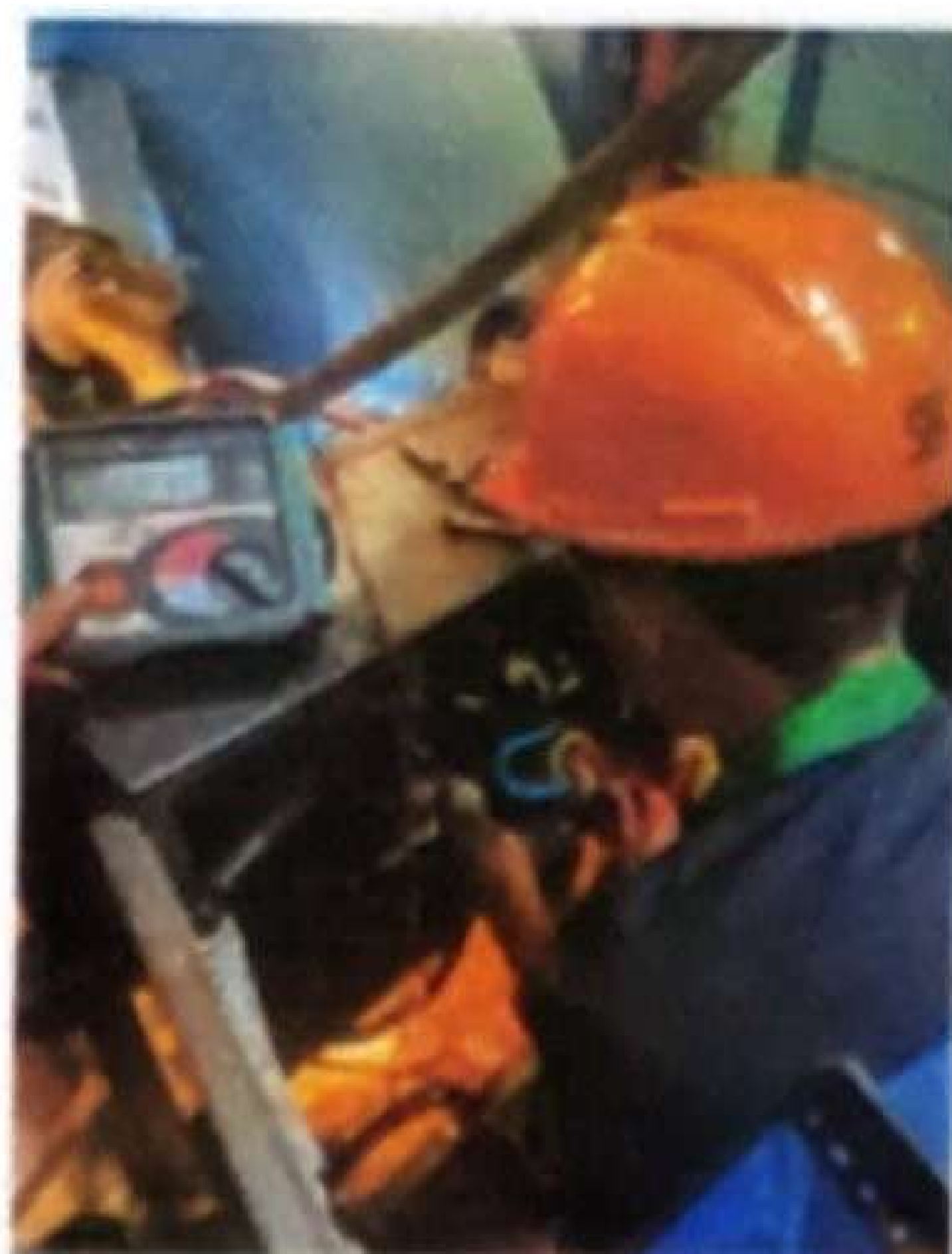
Gambar 1.7 Proses megger test generator
