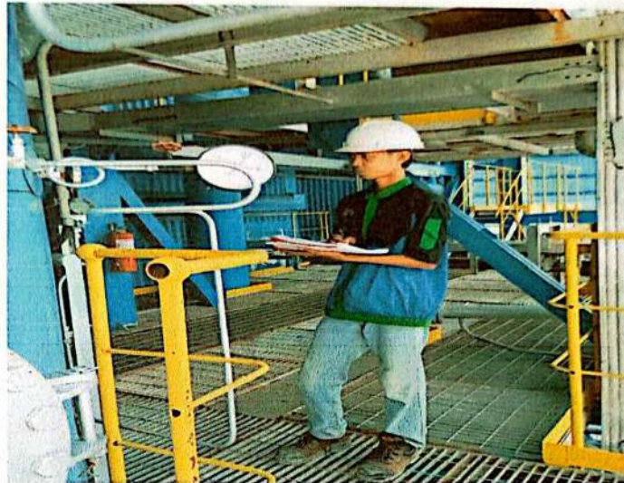
Gambar 2.6 Pengecekan Transmitter di Deaerator
