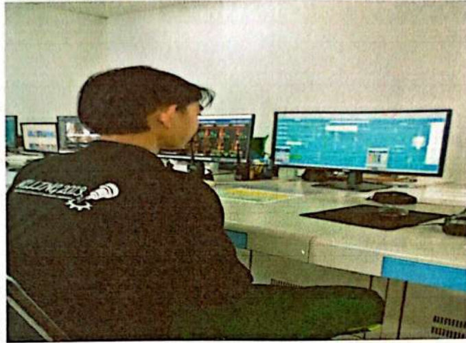
Gambar 2.14 pengontrolan sistem turbine di komputer
