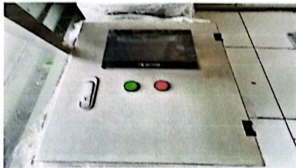
Gambar 1.3 Panel PLC dengan HMI application
