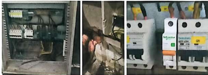
Gambar 8. MCB Pada panel listrik
