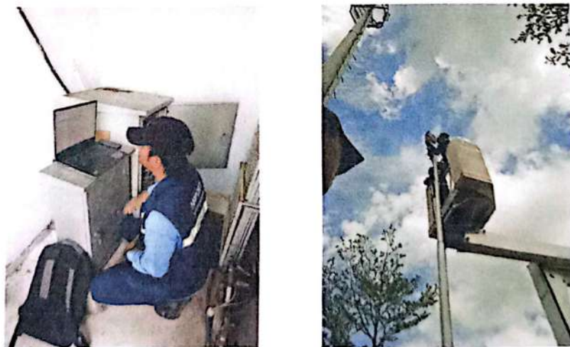
Gambar 18. Pengecekan dan Maintenance CCTV
