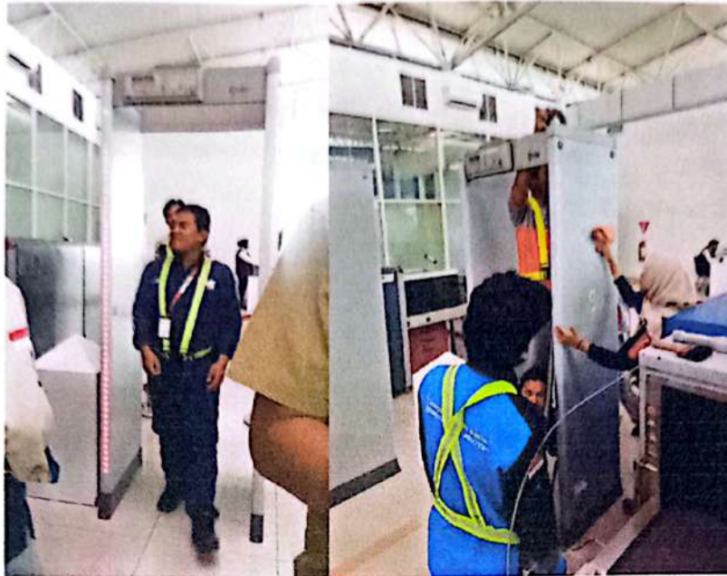
Gambar 15. Maintenance Pada WTMD
