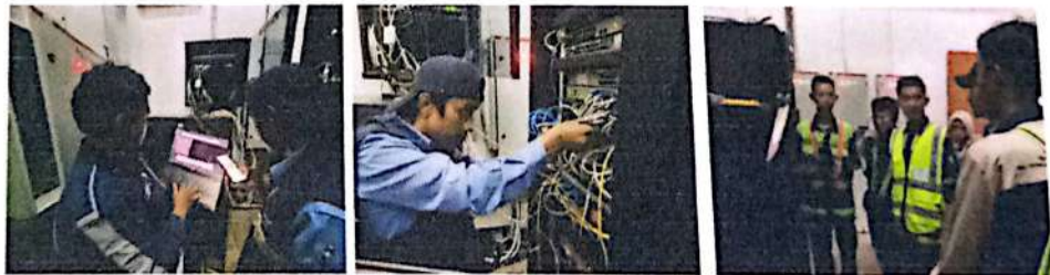
Gambar 19. Pemeliharaan Ruangan Server
