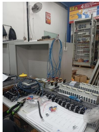
Gambar 2. 5 Wiring Panel PT. WIJAYA KARYA REKAYASA KONTRUKSI
