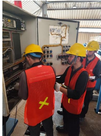
Gambar 2. 11 Proses pengecekan dan pemberian tagging kabel panel PT. JAWA MANIS RAFINASI
