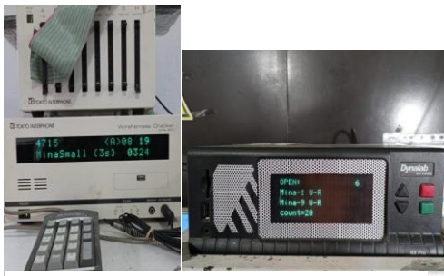
Gambar 1. 4 Mesin atau Alat yang ada di RWSI
