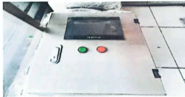
Gambar 1. 4 Panel PLC dengan HMI application
