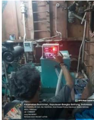
Gambar 2. 14 Pengecekan mesin generator pada kapal Phl-149.
