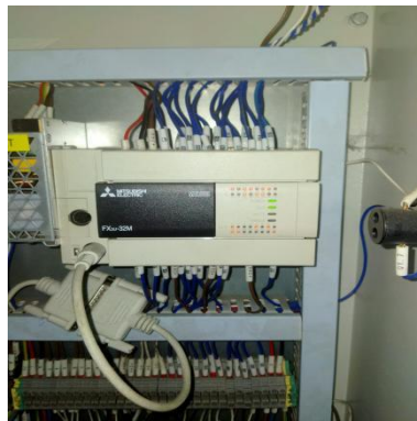
Gambar 4. Wiring electric pada mesin Case Erector .
