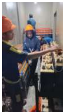
Gambar 2.11 Membersihkan ruang baterai dan mengisi ulang air aki
