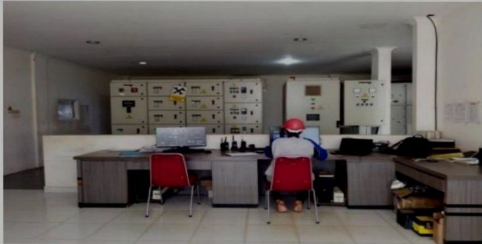
Gambar 1. 18 Panel control dan Scada
